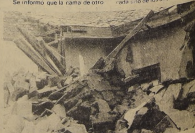
Debajo de los escombros se encuentra la terraza donde juegan numerosos niños en el día. De haberse producido en el día, el derrumbe habría provocado una tragedia.
