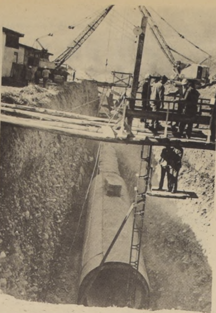
Los trabajadores en las obras de conductos de educación. Estos pasan bajo la línea del Ferrocarril Militar.
