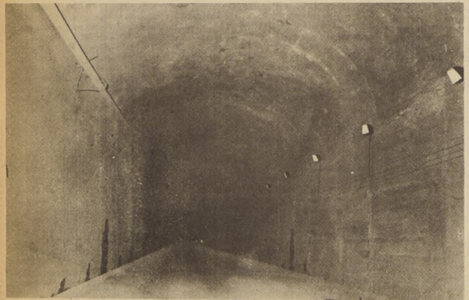
Ya están finalizadas obras interiores del Túnel Chacabuco. Sin embargo, Vialidad está empeñada en comenzar las obras de ensanche de los accesos, por lo que el tránsito por el mismo queda suspendido.
