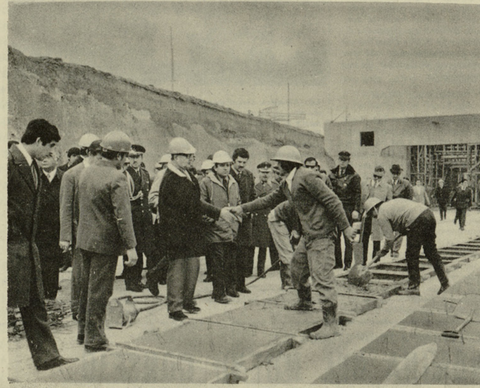
El Presidente de la República, Salvador Allende, visitó, a las 10 horas de ayer, los trabajos del Metropolitano de Santiago. El primer tramo tiene una longitud de 14,7 kilómetros.
