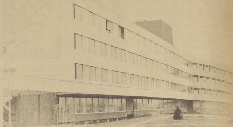
Fachada Oriente del nuevo edificio de la Clínica Alemana que se construye en la intersección de las Avenidas Vitacura y Manquehue, tiene una superficie edificada de aproximadamente 14.000 metros cuadrados, con una capacidad de 250 camas de hospitalización. Se
