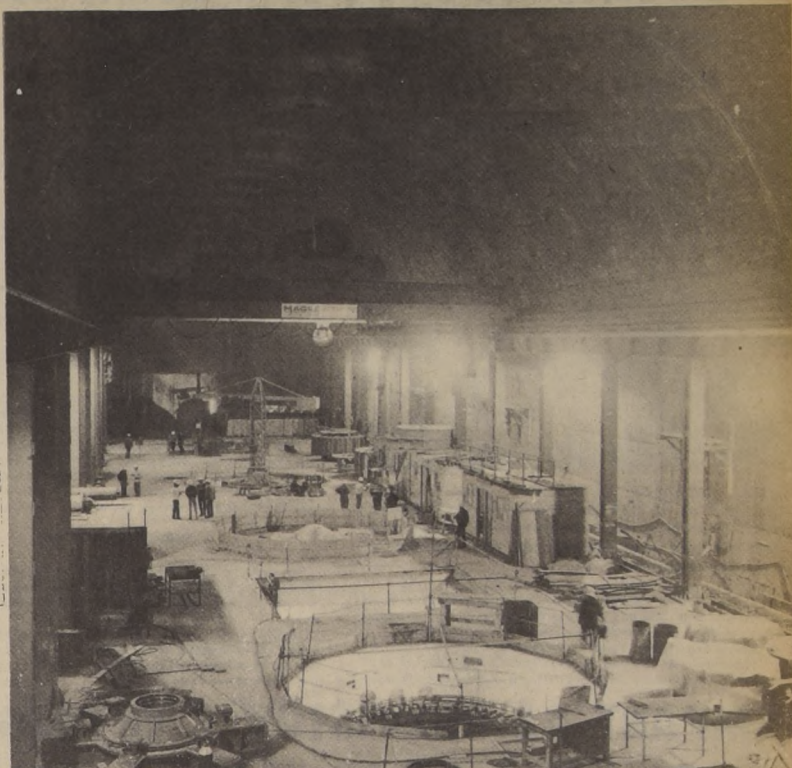
Caverna de la Casa de Máquinas de la Central "El Toro", de 400.000, obra de ENDESA.
