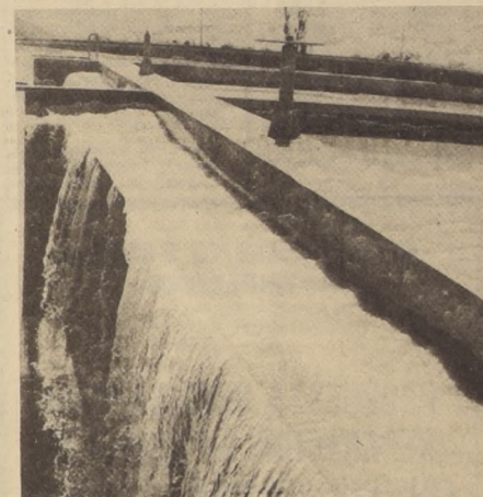
Aquí comienza el proceso de purificación del agua que se abastece por medio de un sistema de aducción de aguas provenientes del río "Maipo", al Tercer Acueducto, que se inaugura hoy con presencia del Presidente Allende. Este primer tramo favorecerá el abastecimiento de agua potable a diversas poblaciones de los sectores norte-oeste de Santiago y sur de la capital.
