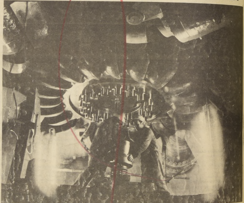
Los trabajadores durante el proceso de montaje de una de las turbinas de "El Toro".
