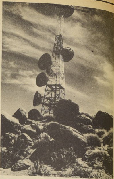
Torre de la Empresa Nacional de Telecomunicaciones, similar a la que existe en el Cerro Caracol, fue objeto de un atentado terrorista, para aislar la ciudad de Concepción del resto del país.
