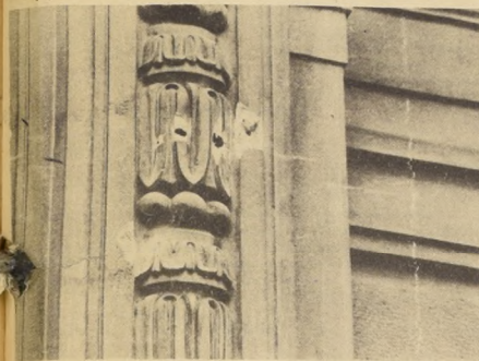
Las murallas del Banco del Estado, Huérfanos con Morandé, muestran impactos de bala. Fue en los primeros momentos de la balacera, cuando los insurgentes dispararon a "diestra y siniestra" tratando de despejar las calles céntricas.
