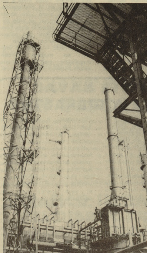
Instalación de amoniaco de la fábrica de abono de Piesteritz, un ejemplo de la integración económica socialista. Mil obreros especializados de la RDA, la URSS, Polonia, Checoslovaquia, Hungría y Yugoslavia levantan en conjunto la nueva obra.
