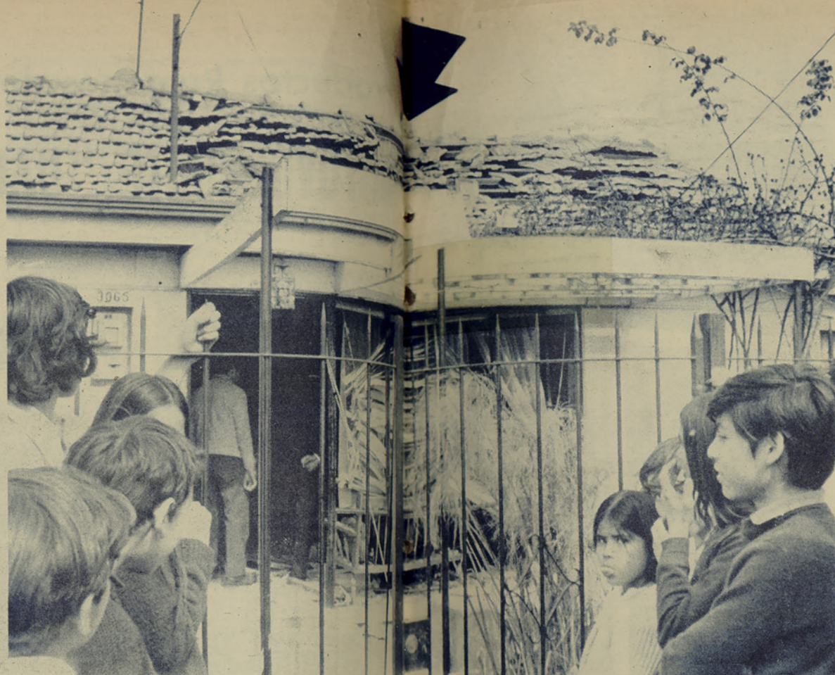
LA FLECHA MUESTRA el tejado de la casa de calle Andrés Fernández Coma; la fuerza del estallido arrancó de cuajo incluso el tejado del inmueble.
