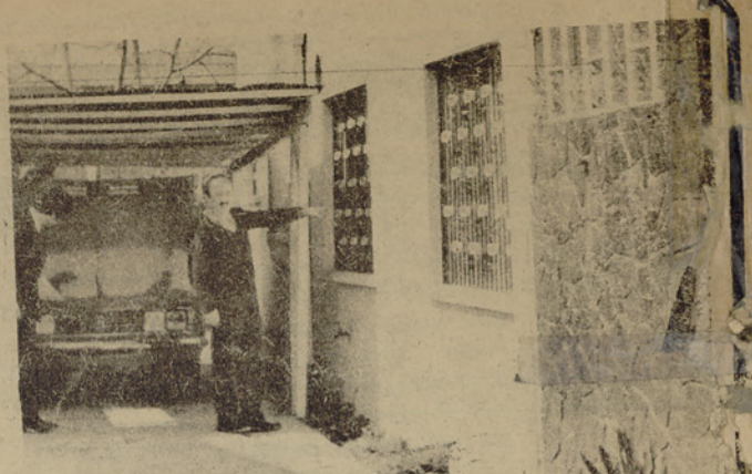
Benjamin Teplisky, Vicepresidente de la UP, muestra él los ventanales de su vivienda que sufrió serios daños a raíz de la explosión de una carga de dinamita.
